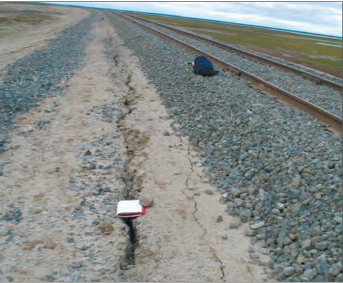
Рис. 5. Продольные трещины вдоль насыпи, образовавшиеся из-за неправильного расположения теплоизоляционных плит
