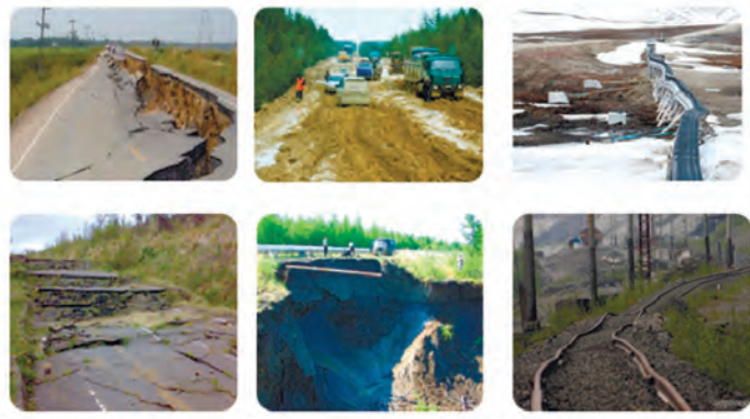
Рис. 2. Примеры разрушения дорожных сооружений на ММП
