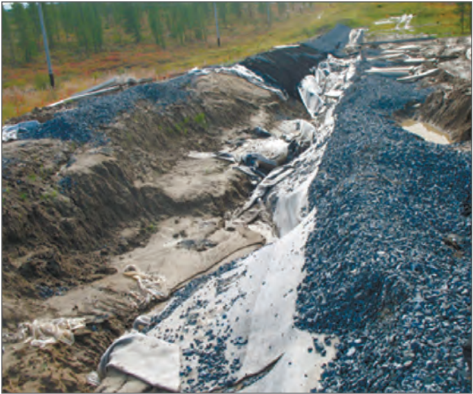
Рис. 11. Разрушение водоотводной канавы вследствие ошибок при проектировании
