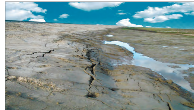
Рис. 1. Откосы насыпи, отсыпанной из пылеватых суглинков, после оттаивания весной
