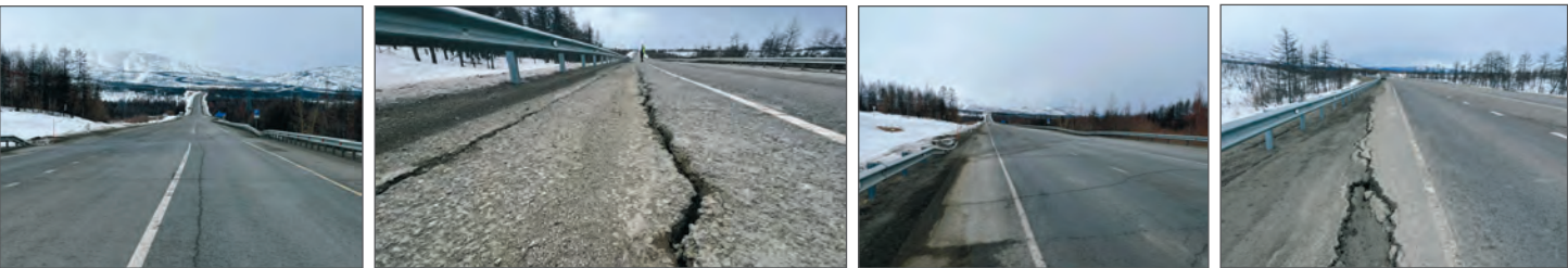
Рис. 3. Дефекты асфальтобетонного покрытия на автомобильной дороге Р-504 «Колыма» на участке от Магадана до пгт. Палатка.
